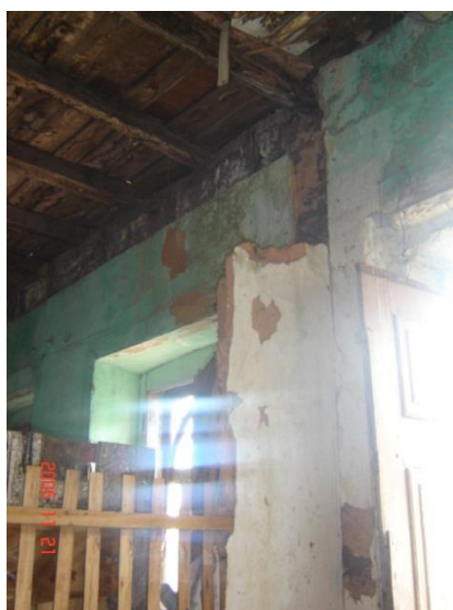
Foto nº 3 – Detalhe da parede desmoronada do imóvel do Beco Pacotilha nº 194.
