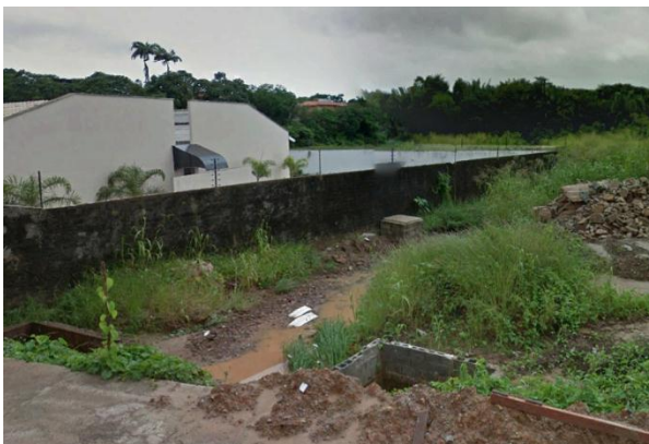
Figura 43 – Aterramento das margens do rio. Fonte: Google Street View, 2015.
