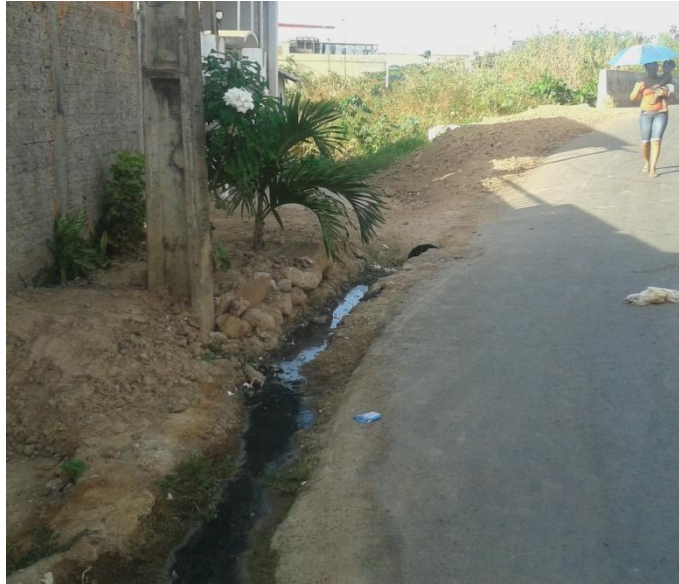
Figura 60 – Esgoto a céu aberto destinando-se para o Rio, em comunidade próximo ao Shopping do Automóvel
