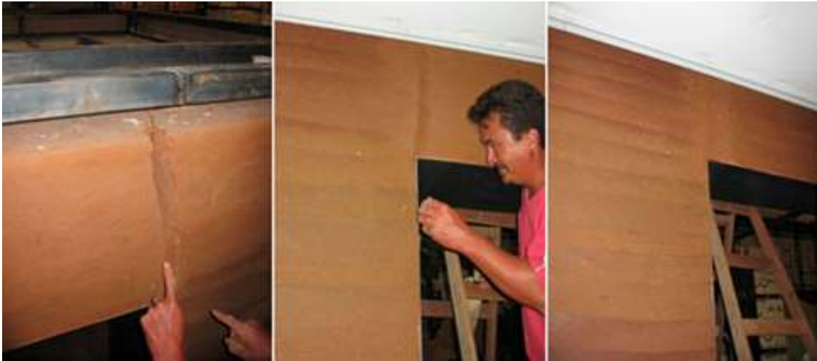
Figura 9 - Consolidação de trinca em painel monolítico
