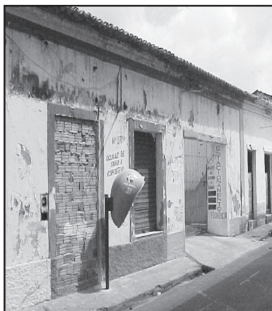
Foto 42 - Edificação em ruínas no CH, transformada em estacionamento rotativo.
