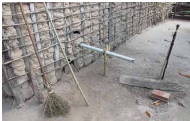
Figura 72 - Criação doméstica atraída pelas águas servidas da cozinha de moradia de adobe, Vila das Almas, Brejo. Figuras 73 e 74 - Escoamento no terreno das águas servidas de jirau de casa de taipa de mão, Santa Luzia, Cantanhede e São Miguel dos Correia, Cajari.
