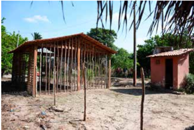
Figuras 1 e 2 - Estruturas com esteios e madeirame da cobertura em construção de moradia de taipa de mão, Pequizeiro, Belágua. Figura 3 - Montante de madeira aparelhada e varas para tapagem de casa de taipa de mão já coberta com telhas cerâmicas, Aldeia Areião, Terra Indígena Rio Pindaré, Bom Jardim.
