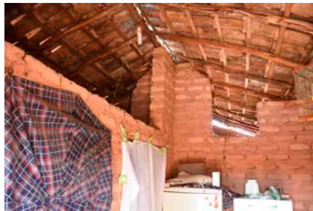
Figuras 41, 42 e 43 - Madeirame roliço em coberturas de fibrocimento, Mato Grosso, São Luis, palha de pindova e telha artesanal de barro em moradias de adobe, Pequizeiro, Belágua.
