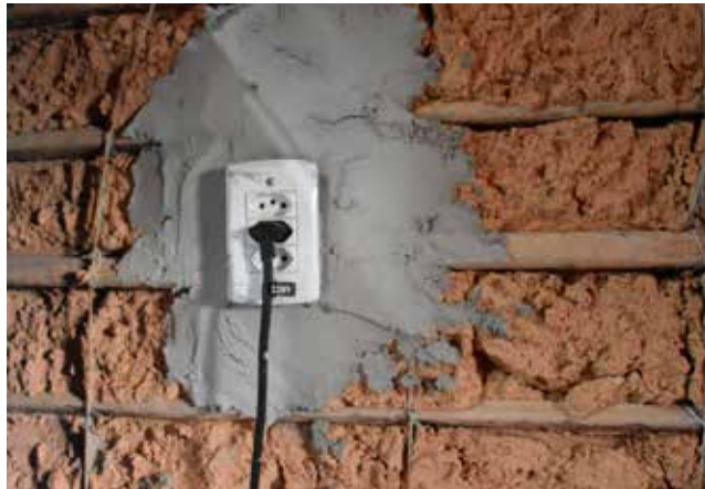
Figura 66 - Interruptor e tomada com eletroduto rígido e caixa 4x2 em casa de taipa de mão, Aldeia Januária, Terra Indígena Rio Pindaré.
