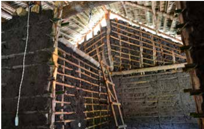
Figura 16 - Parede frontal de casa de taipa de mão que sofreu rebaixamento, obrigando criação de desnível para possibilitar a abertura da porta de entrada, Gameleira, Cajari.
