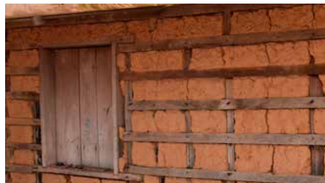
Figura 12 - Casa de taipa de mão com entramado de varas de madeira e montante de esquina com reaproveitamento de tubo de aço de antiga prospecção da Petrobrás, Caeté, Primeira Cruz Figura 13 - Entramado de taipa de mão executado com ripas de madeira de serraria da região, Nova Conquista, Zé Doca.
